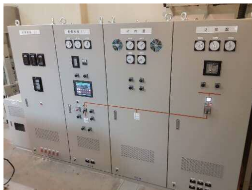
水車等の操作制御盤
