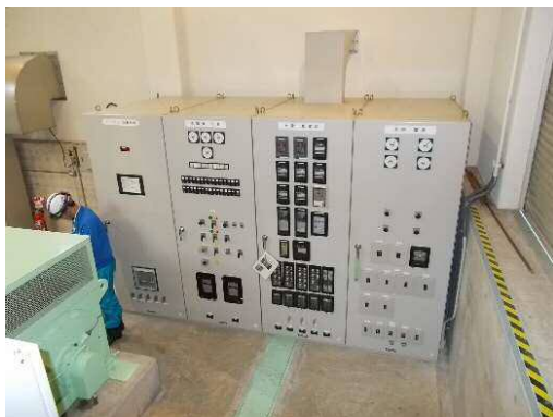
水車等の操作制御盤
