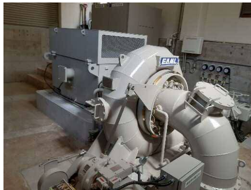
水車・発電機
