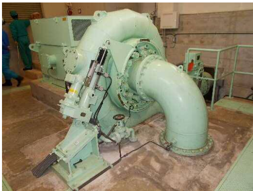
水車・発電機
